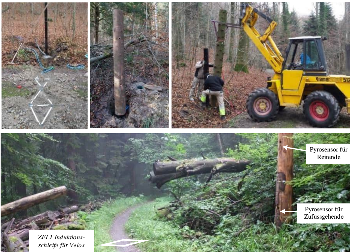
Abbildung 25: Oben: Installation eines Multizählers mit Veloschleifen, sowie Pyrosensoren zur Erfassung von Zufussgehenden & Reitenden; Bild unten: gleiches Zählgerät in Betrieb (Fotos: Ronald Schmidt, Wildnispark Zürich)
